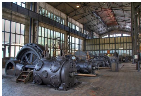
Pohled do strojovny dolu Michal ( https://www.dul-michal.cz/cs/informace-pro-navstevniky/prohlidkove-okruhy/771-cesta-havire-do-prace-a-zazemi )
