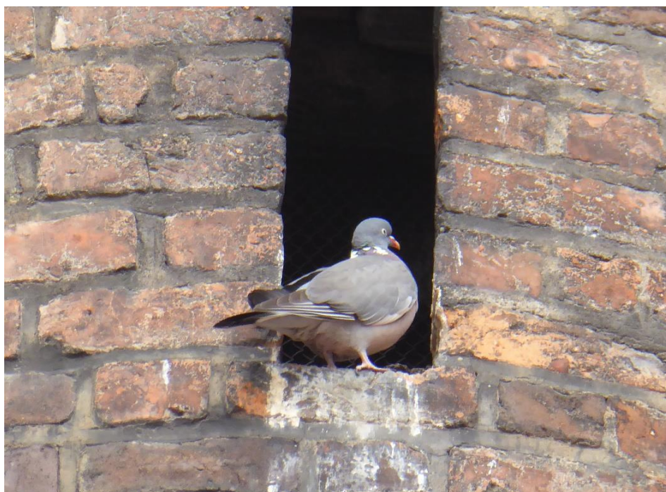
Obrázek 49. Znečištění cihelného pláště ptactvem (foto David Witoš 2019).
