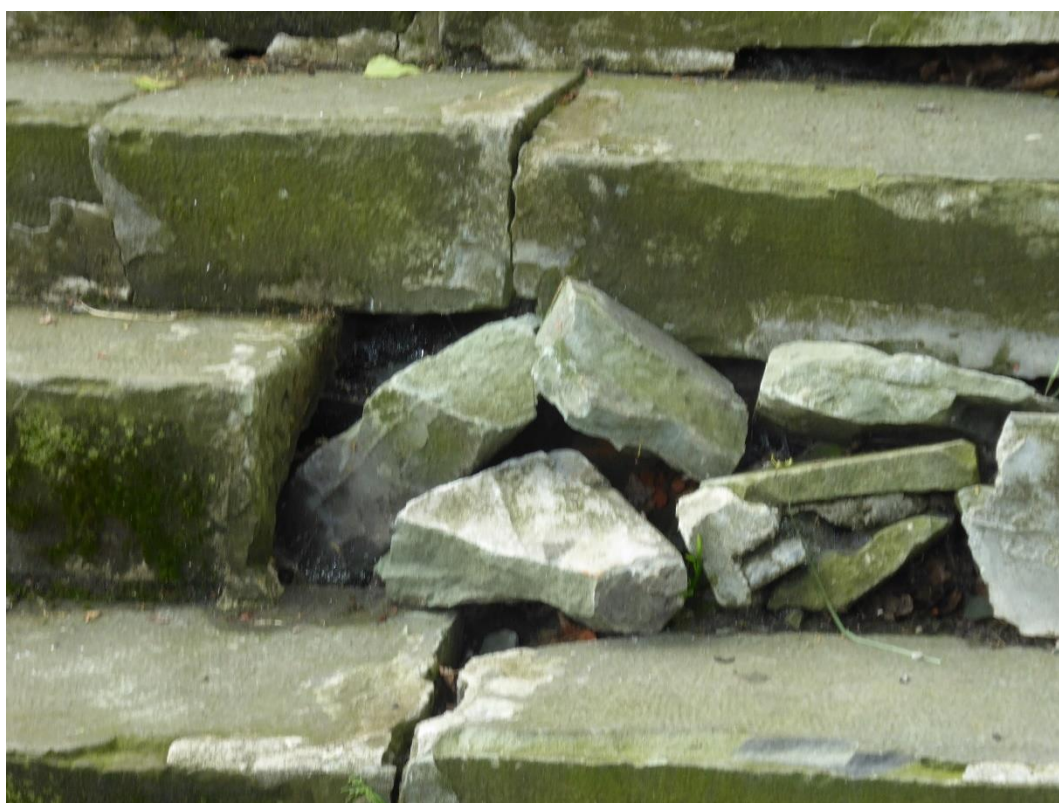
Obrázek 62. Degradace schodišťových stupňů (foto David Witoš 2019).
