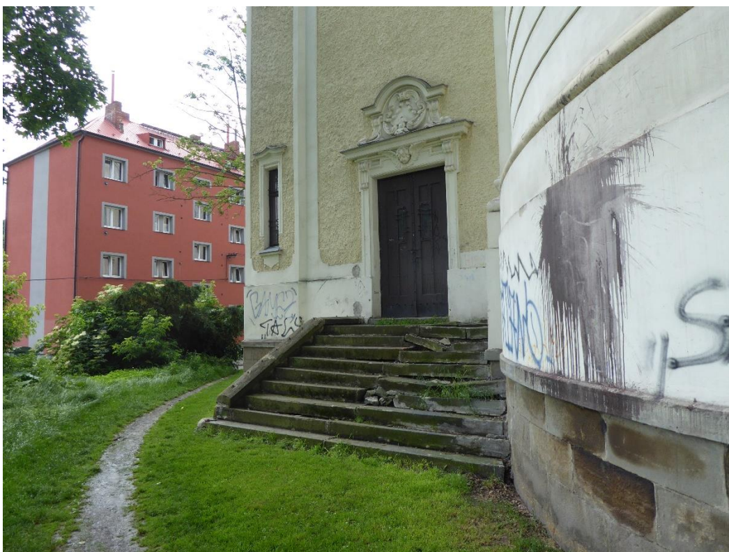
Obrázek 61. Ukázka vandalismu na východním průčelí kostela včetně degradace schodišťových stupňů (foto David Witoš 2019).
