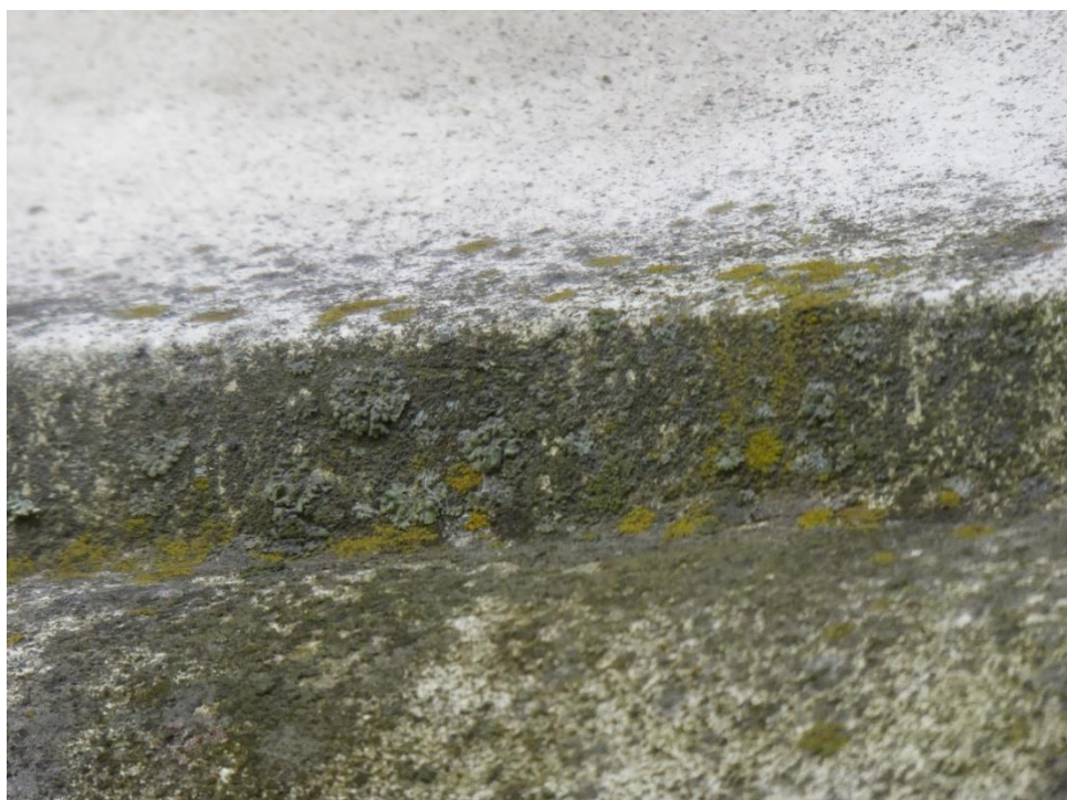
Obrázek 64. Biologické napadení soklu jižní stěny lišejníkem (foto David Witoš 2019).
