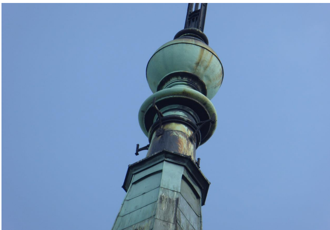
Obrázek 54. Koroze měděného plechu na makovici severní věže (foto David Witoš 2019).
