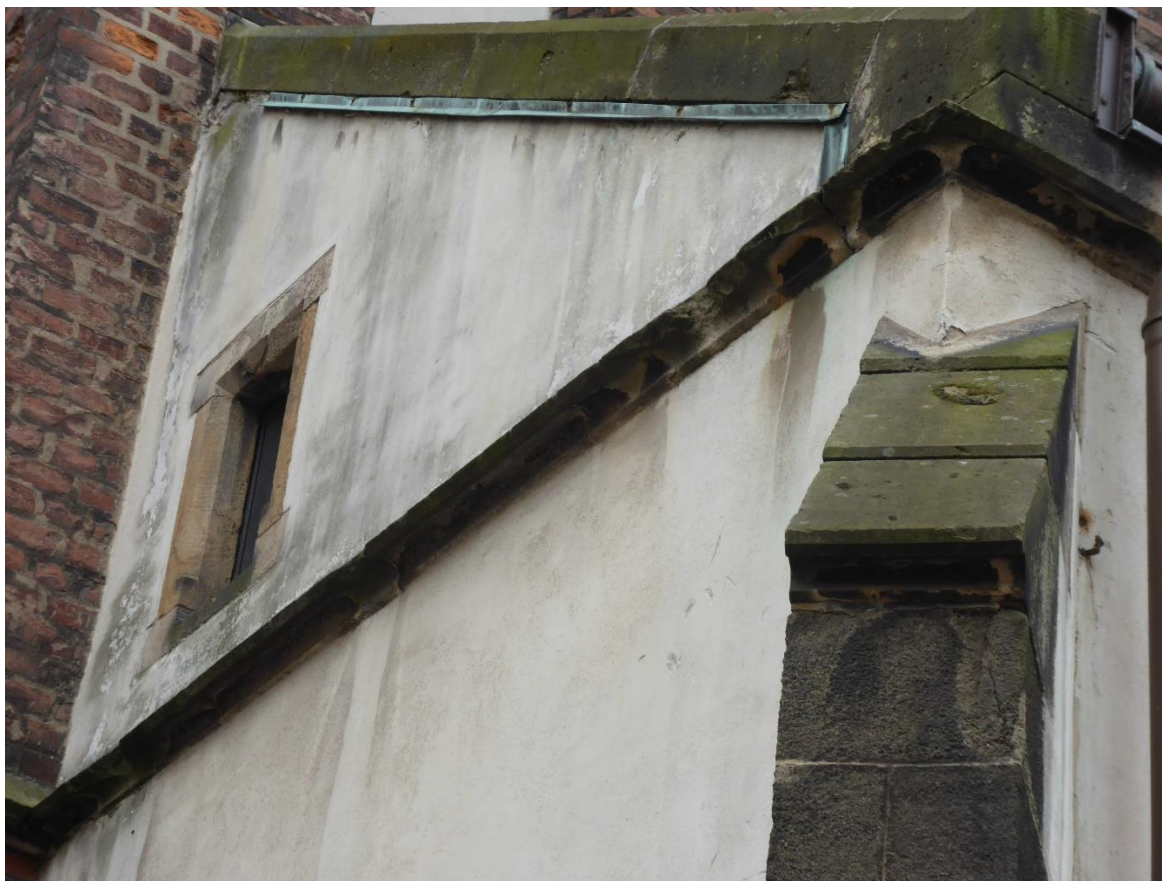
Obrázek 45. Korunní římsa na východní straně kaple Panny Marie Bolestné pokrytá vrstvou řas. Římsa a dělicí štít pokrytý černou vrstvou sádrovcové krusty (foto David Witoš 2019).
