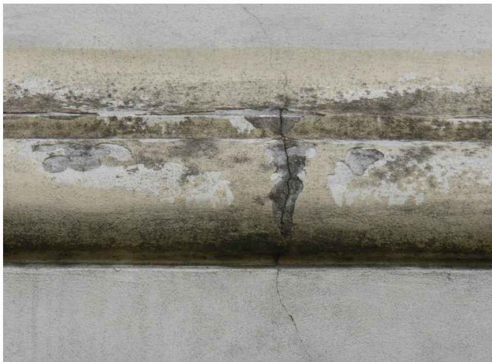
Obrázek 63. Trhliny na obloukové římsě v závěru presbytáře (foto David Witoš 2019).
