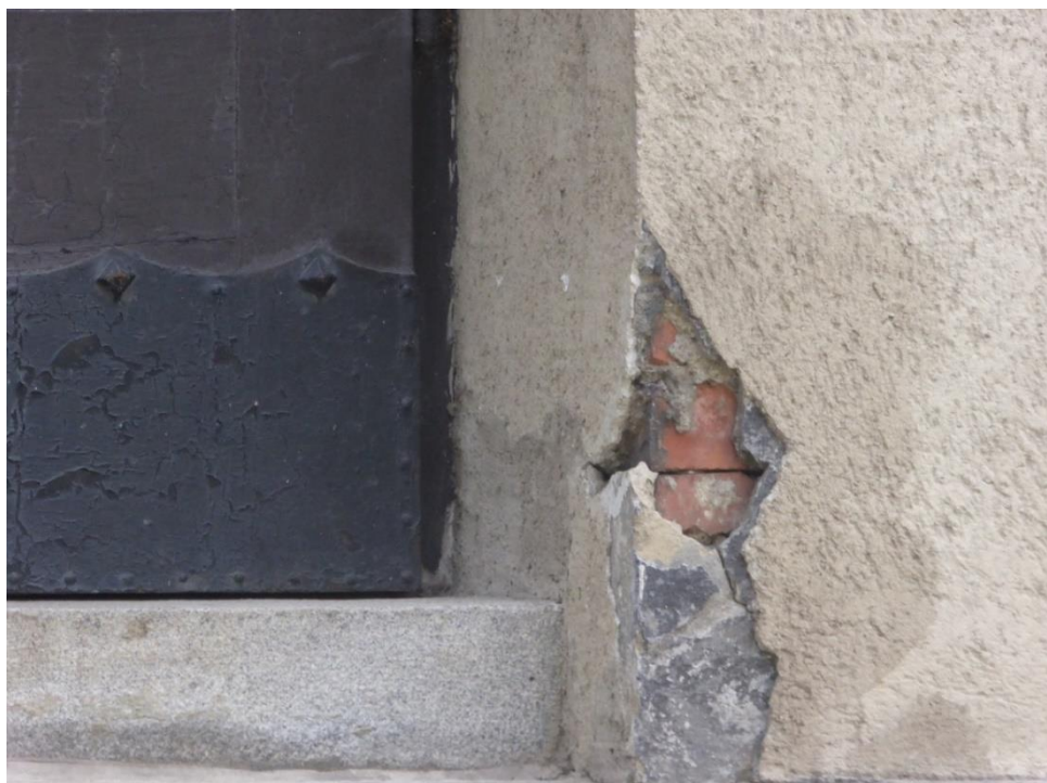
Obrázek 55. Degradace části omítky v severním průčelí (foto David Witoš 2019).
