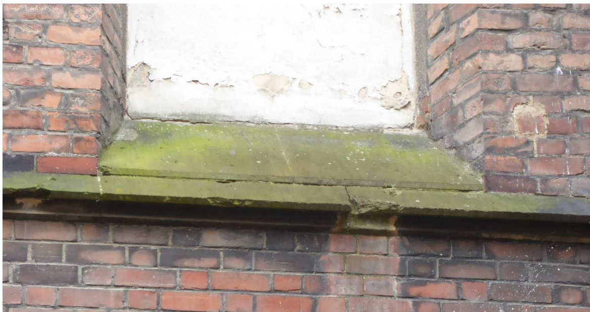
Obrázek 44. Parapet zazděného okenního otvoru na severní straně pokrytý zelenou vrstvou řas (foto David Witoš 2019).
