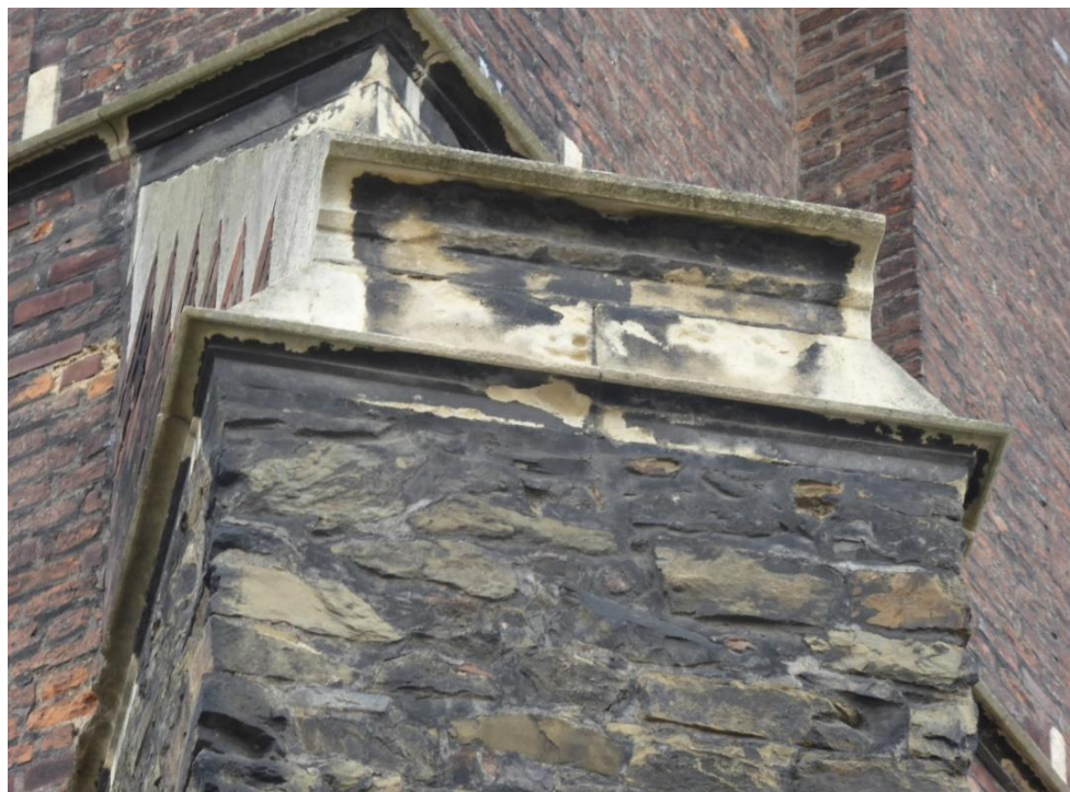
Obrázek 46. Sádrovcová krusta na krycí desce severozápadního opěráku severní věže (foto David Witoš 2019).
