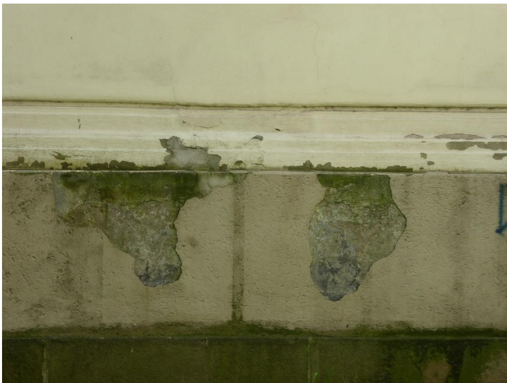
Obrázek 66. Biologické napadení soklu jižní stěny povlakem řas a fyzická degradace omítkových vrstev (foto David Witoš 2019).
