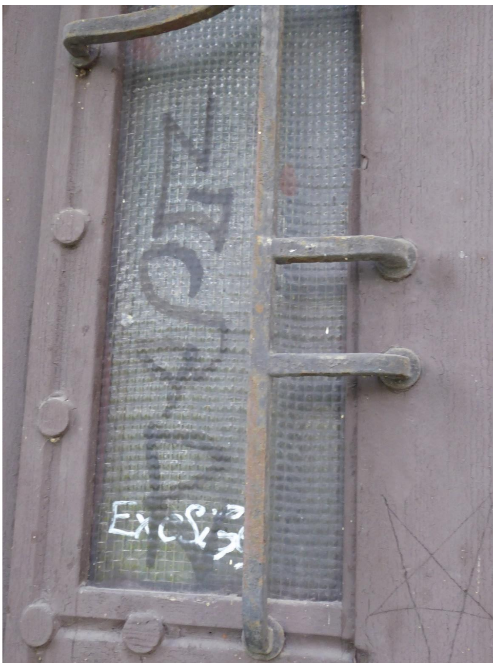
Obrázek 71. Koroze kování dveřní výplně (foto David Witoš 2019).
