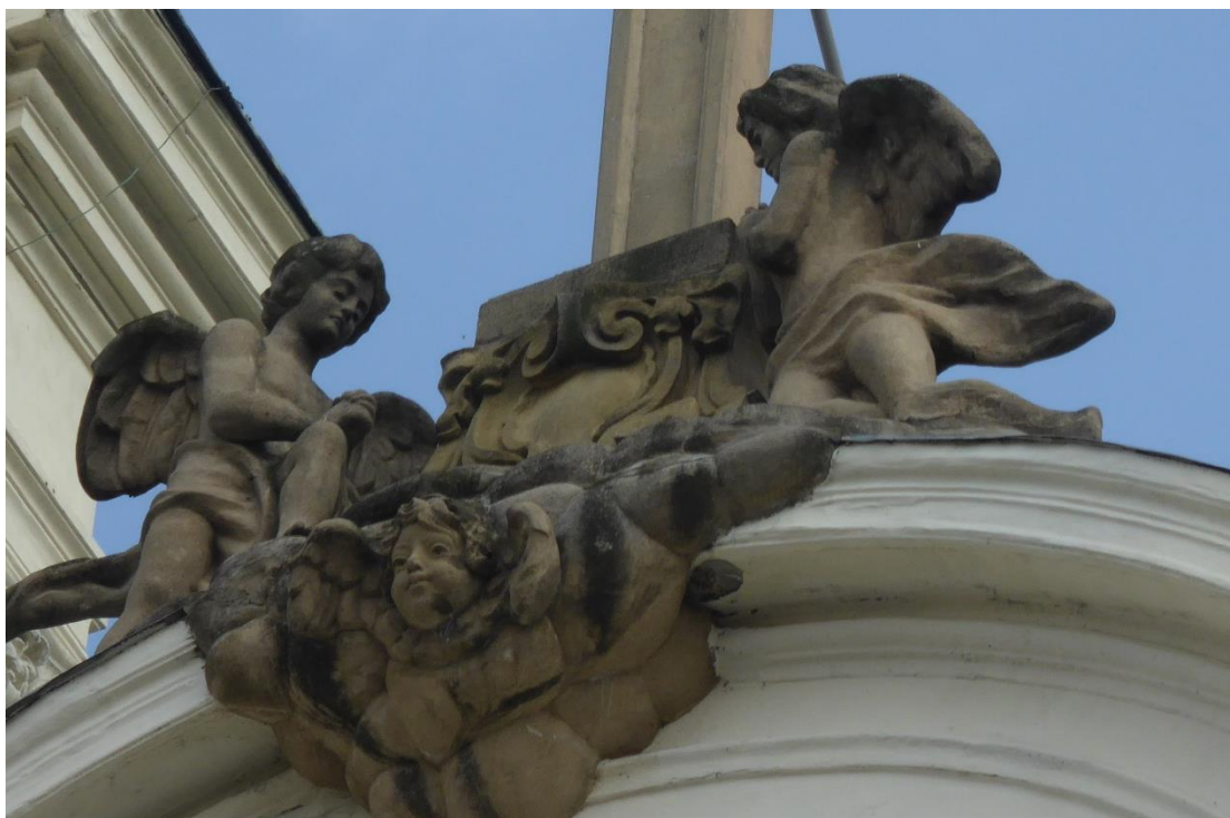
Obrázek 53. Sousoší adorujících andělů nad rizalitem jihozápadního průčelí pokryté černou sádrovcovou krustou (foto David Witoš 2019).
