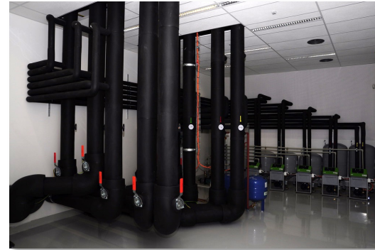
Chlazení teplou a studenou vodou, rekuperační systém
