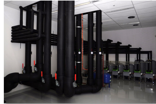
Chlazení teplou a studenou vodou, rekuperační systém
